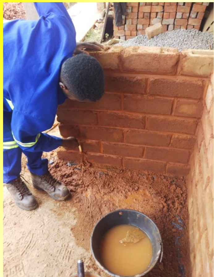
Initiation aux travaux de finition (traitement des joints ou tirage des joints)
